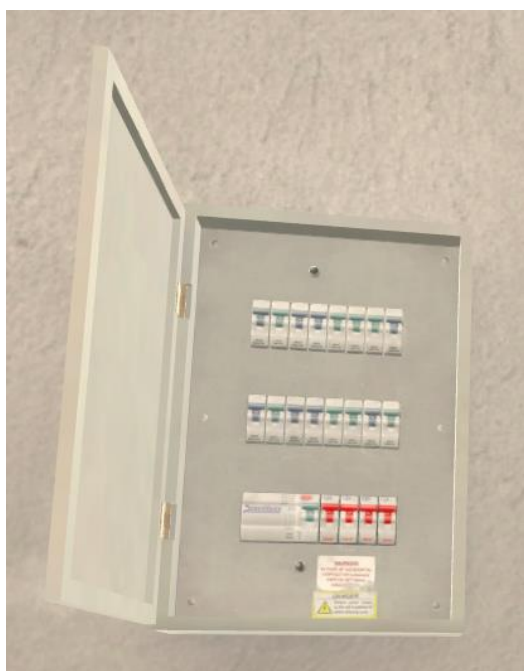
Figura 14: quadro elettrico aperto
