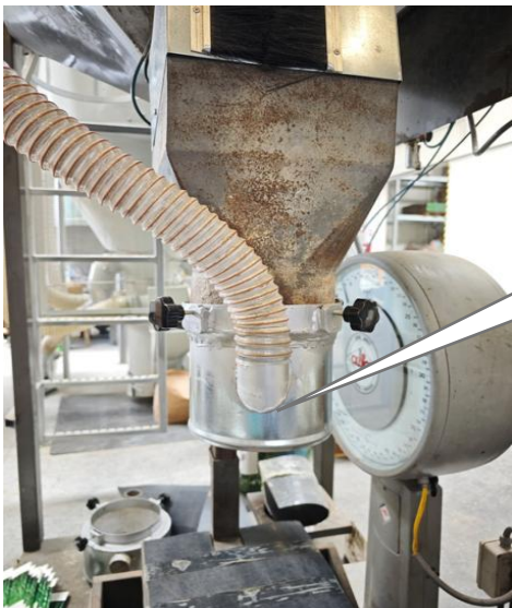
Foto 2 – Bocca di carico con dispositivo di captazione polveri modificato
