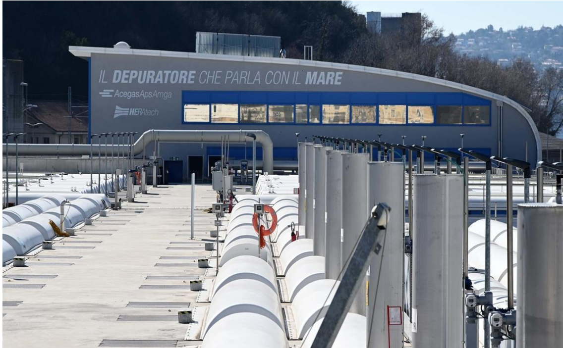
Figura 1: Il depuratore di Servola. Sotto le cupole bianche sono presenti i vari reattori del comparto biologico dell'impianto di depurazione.
