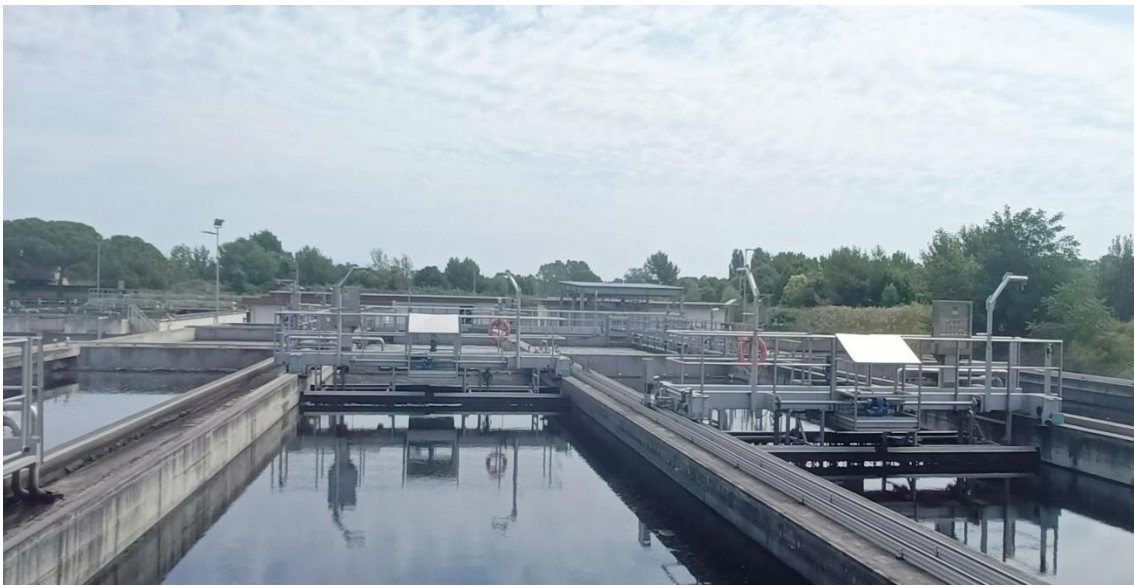
Figura 3: Vasche di ossidazione per la fase di depurazione biologica.
