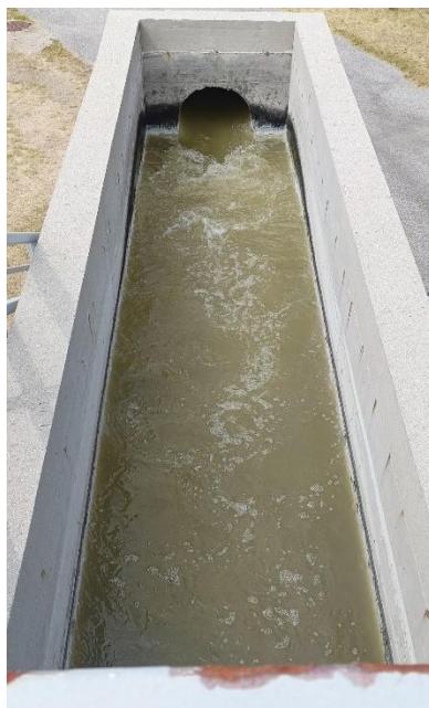
Figura 2: Reflui in entrata all'impianto di depurazione di Grado in cima al torrino di carico.
