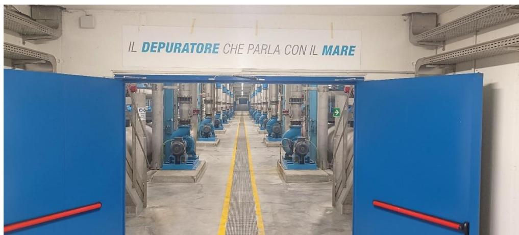
Figura 2: Sala turbine soffianti a servizio del trattamento secondario del depuratore di Servola.
